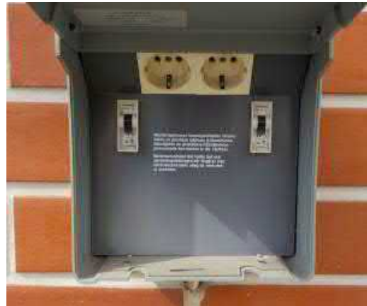
Ajoneuvon lämmityskotelo ulkoseinällä
