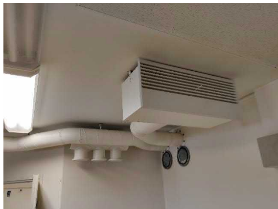
Tuloilmahajottaja ja poistoventtiilit
