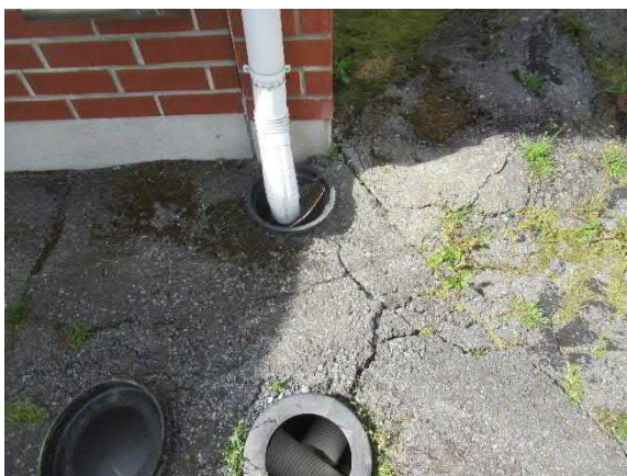
Koilliskulmauksessa asfaltoinnin routavaurioita
