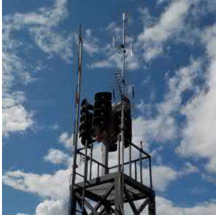
Antenni vesikatolla yhteismastossa
