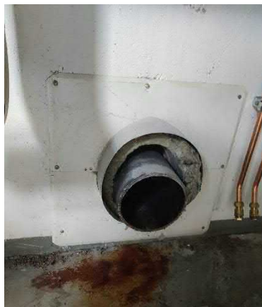
Tiivistämätön savupiipun hormi
