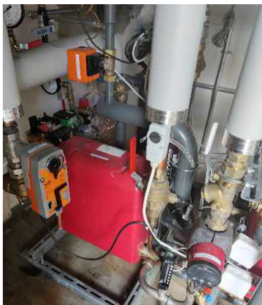
Kaukolämpöpaketti, hyvässä ja siistissä kunnossa.
