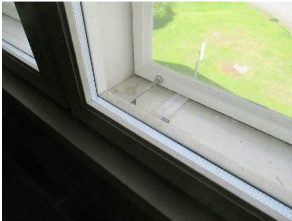
Ikkunoiden väleissä runsaasti likaa/ulkoilmapölyä
