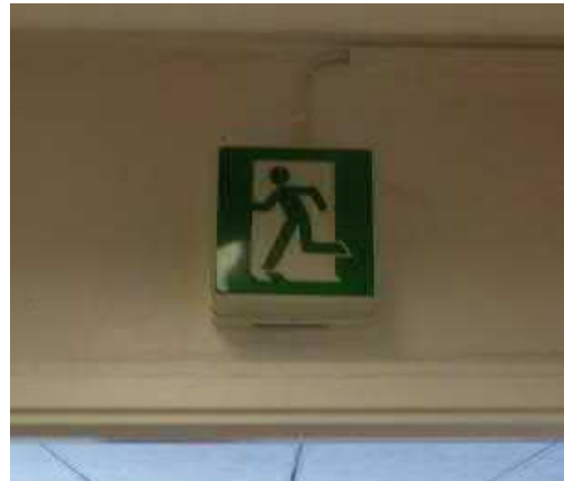
Poistumisvalaisin oven päällä
