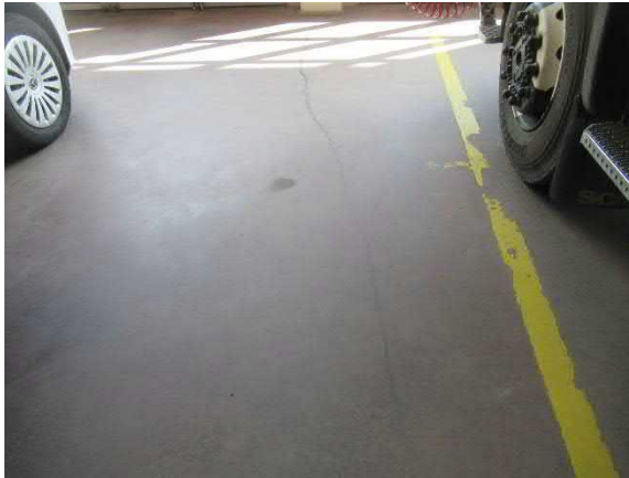
Hallin alapohjassa halkeilua
