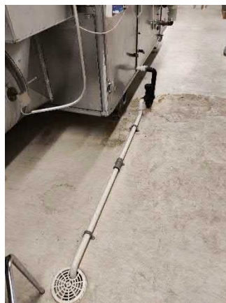
IV-konehuoneen lattiakaivo ja vuotojälkiä.
