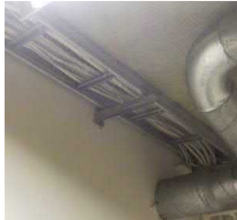
Tikashyllyä teknisessä tilassa
