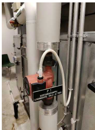
Alkuperäinen IV-kiertopumppu, tekninen käyttöikä ylittynyt.
