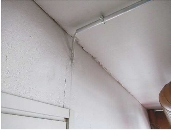
Halkeama betonirakenteisessa seinässä
