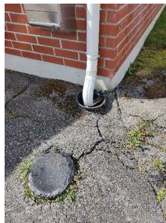
Rännikaivojen läheisyydessä halkeilua.
