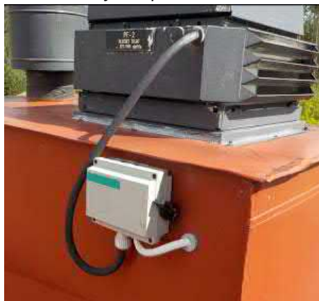
IV-koneen läpivienti vesikatolla
