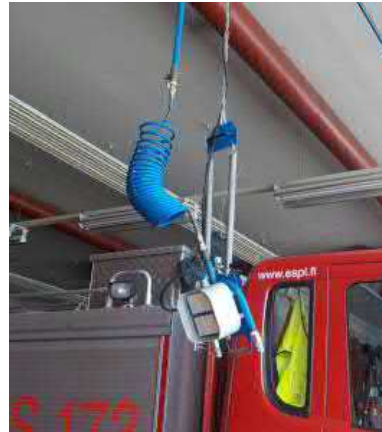
Ripustettu pistorasiakotelo kalustohallissa
