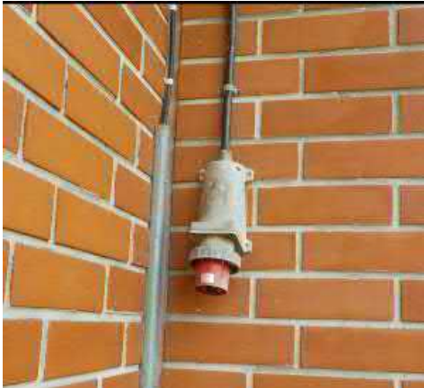
Varavoiman kytkentäpiste rakennuksen takana
