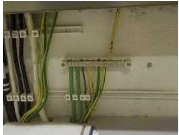
Maadoituskisko pääkeskuksen yhteydessä
