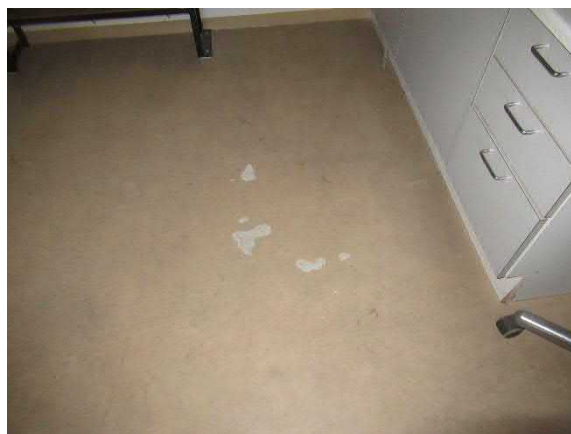
Lattiapintamateriaaleissa kulumaa ja vaurioita
